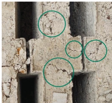
Рис. 5. Трещины от разбухания заполнителя из ТМД на поверхности перегородок пустотелого стенового блока из ТДБ
